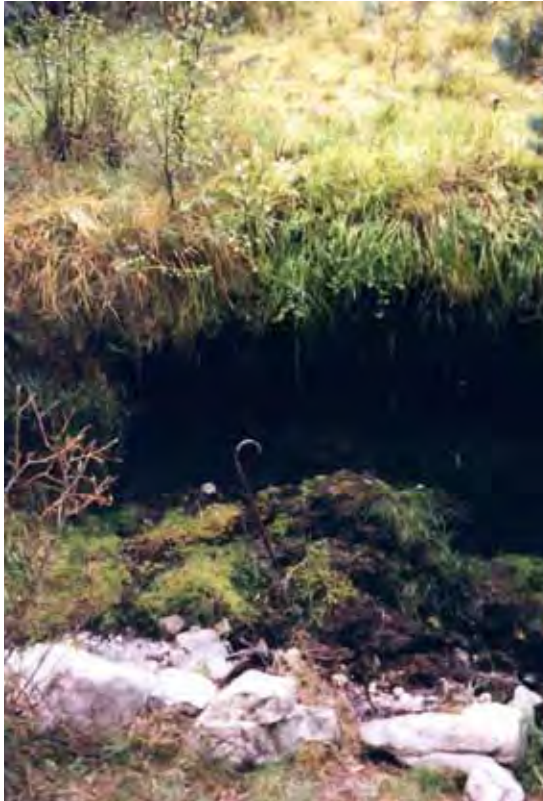
Corte en la turbera producido al construir la pista forestal.
